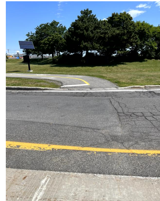
Sentier multifonctionnel sur le boul. Albert-de-Niverville. Source : AECOM
