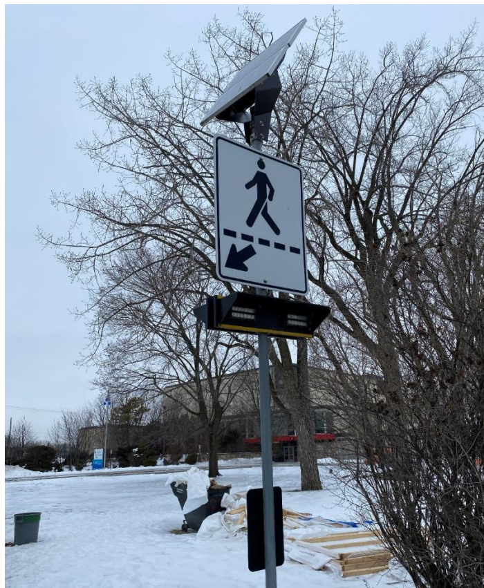
Figure 19 Panneau lumineux défectueux, devant le complexe aquatique
